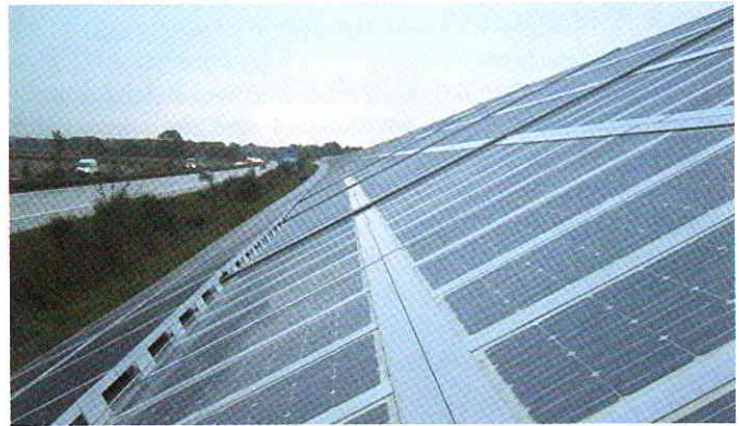
Bild 1. Freising-Lerchenfeld – die weltweit größte kombinierte Photovoltaik-Schallschutzwand
